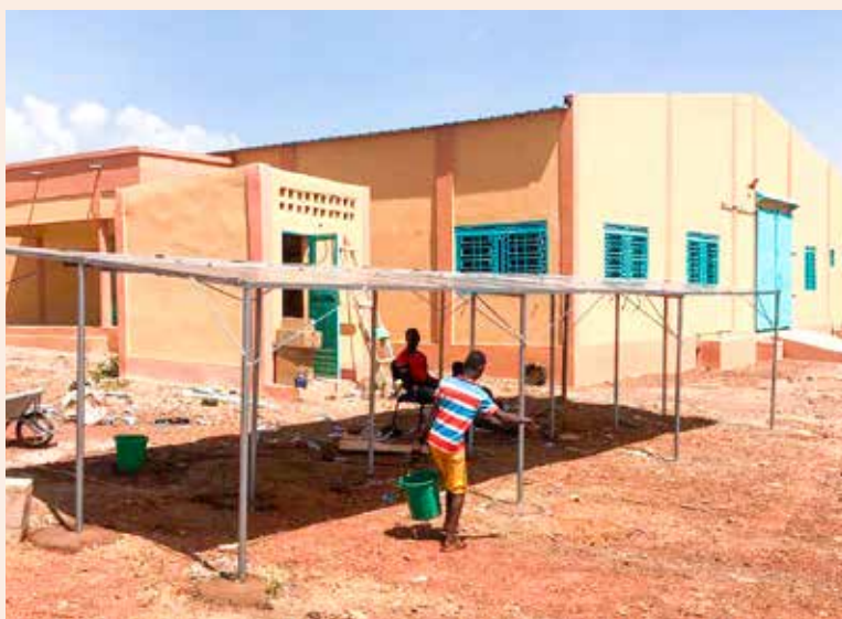
Le site dispose d'installations pour produire de l'énergie solaire.
